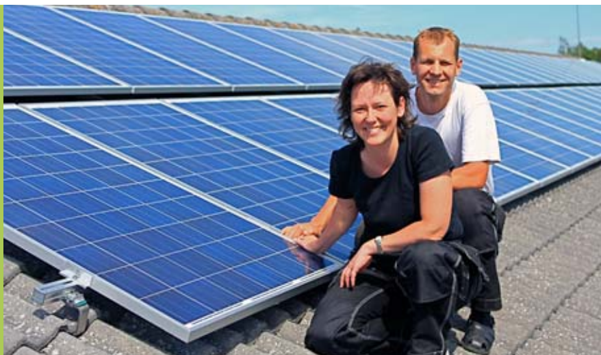
Solect Power installerade en solcellsanläggning på Skånska Energis huvudkontor i Södra Sandby. Solcellerna på 80 m 2 genererar ca 10.000 kWh förnybar el per år.
